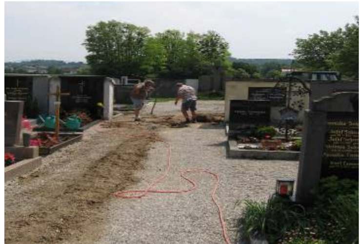
Vorbereitungsarbeiten für die neue Wasserstelle im neuen Friedhof. Hr. Offenberger u. Fixl bei den Grabungsarbeiten für den Wasserschacht.
